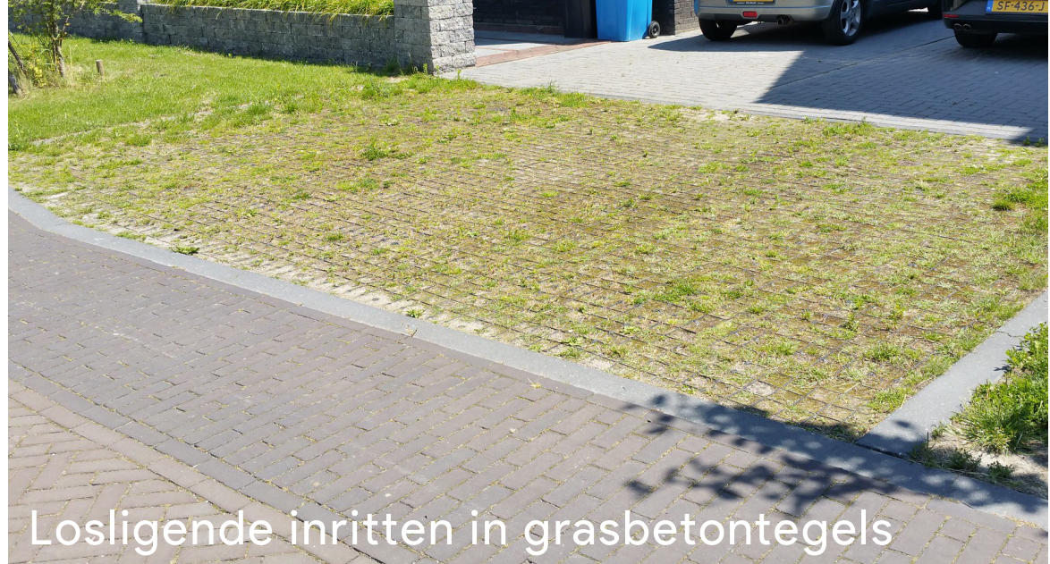
Losligende inritten in grasbetontegels
