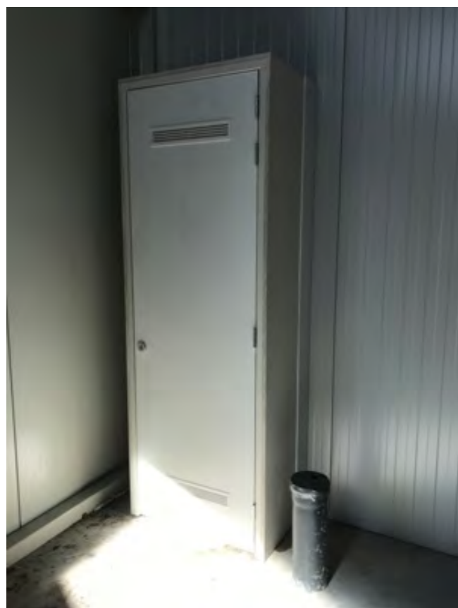
Standaard meterkast + riool (referentiebeeld)
